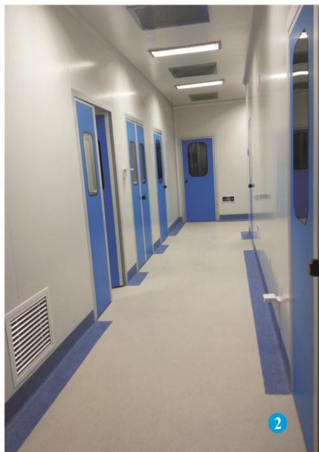
① 洁净走廊 ② 洁净走廊
